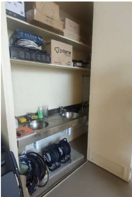
Fotografia de les piques i el cablejat de sota
